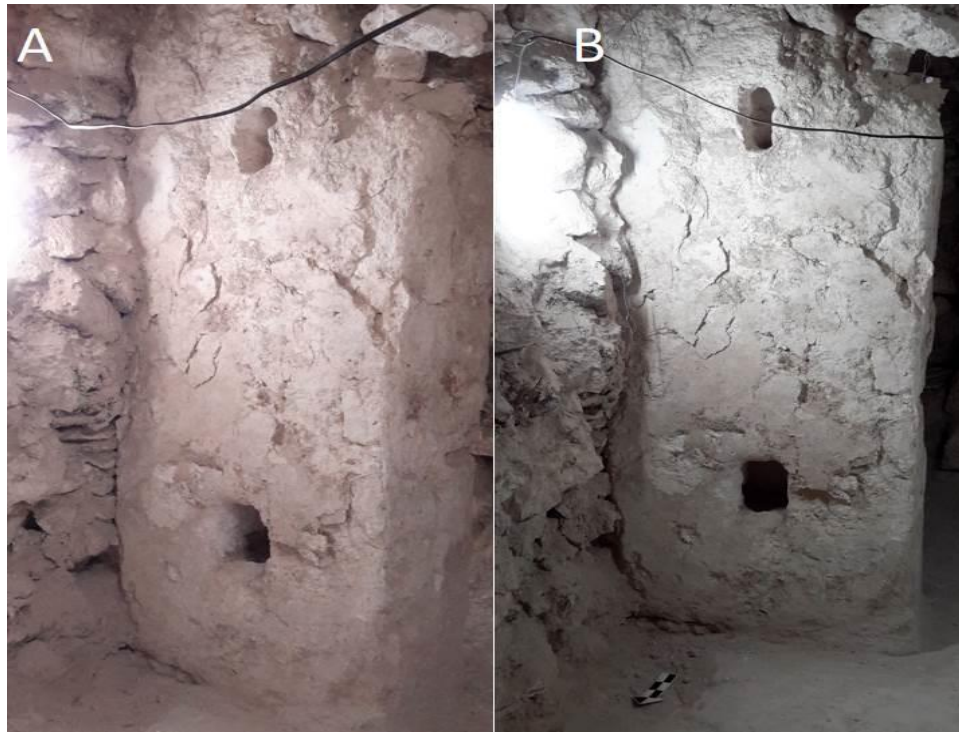
Figura 2.12. A) Vista en perspectiva de la fachada norte del muro HOLT.108.33 con orificios HOLT.108.37 y HOLT.108.38; B) Vista frontal de la fachada norte del muro HOLT.108.33 (Foto: Berenice García Vázquez).
