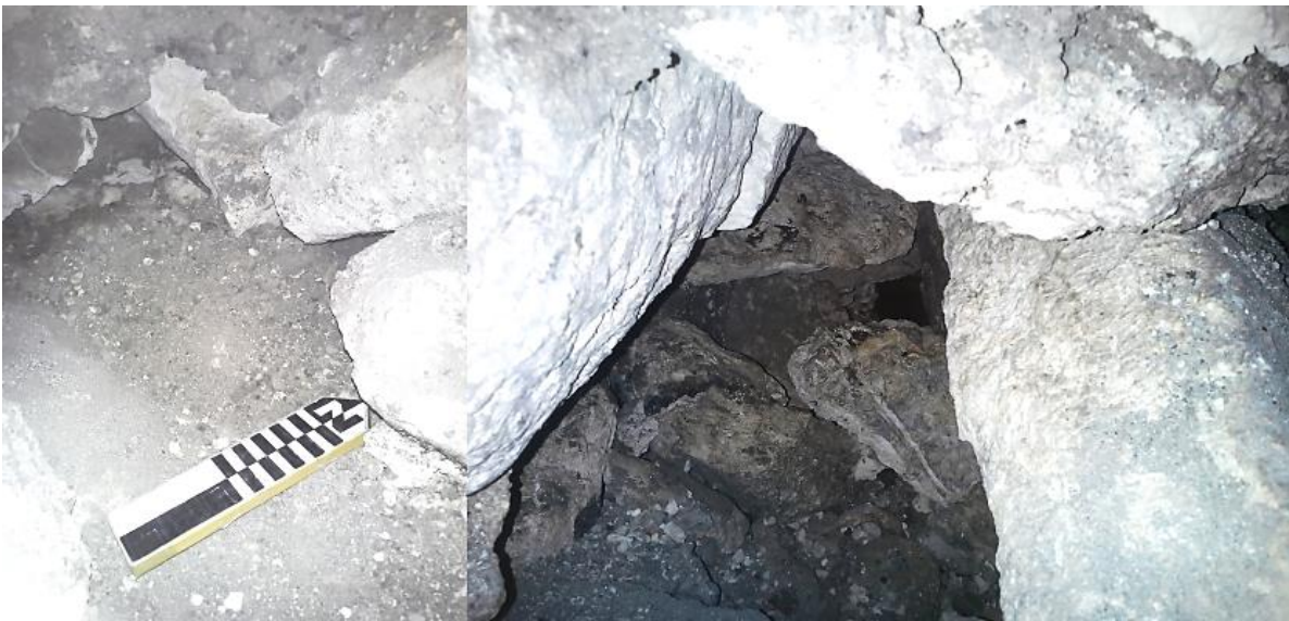
Figura 5.20. Vista de los bloques de la bóveda CHO.L.18.17 colapsada (Foto Bhanny Girón).
